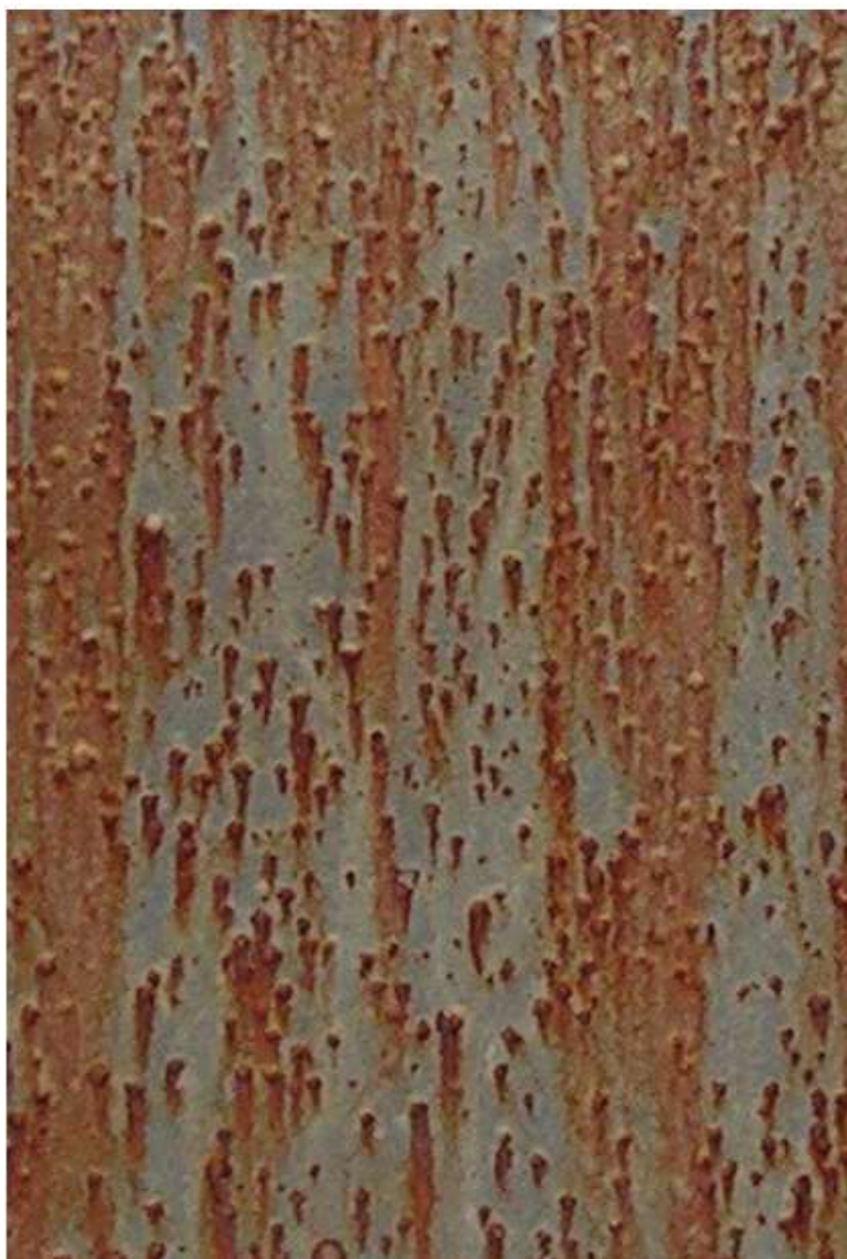
Рисунок Е.1 – Коррозия металла балл К4 (или Ri 4)
