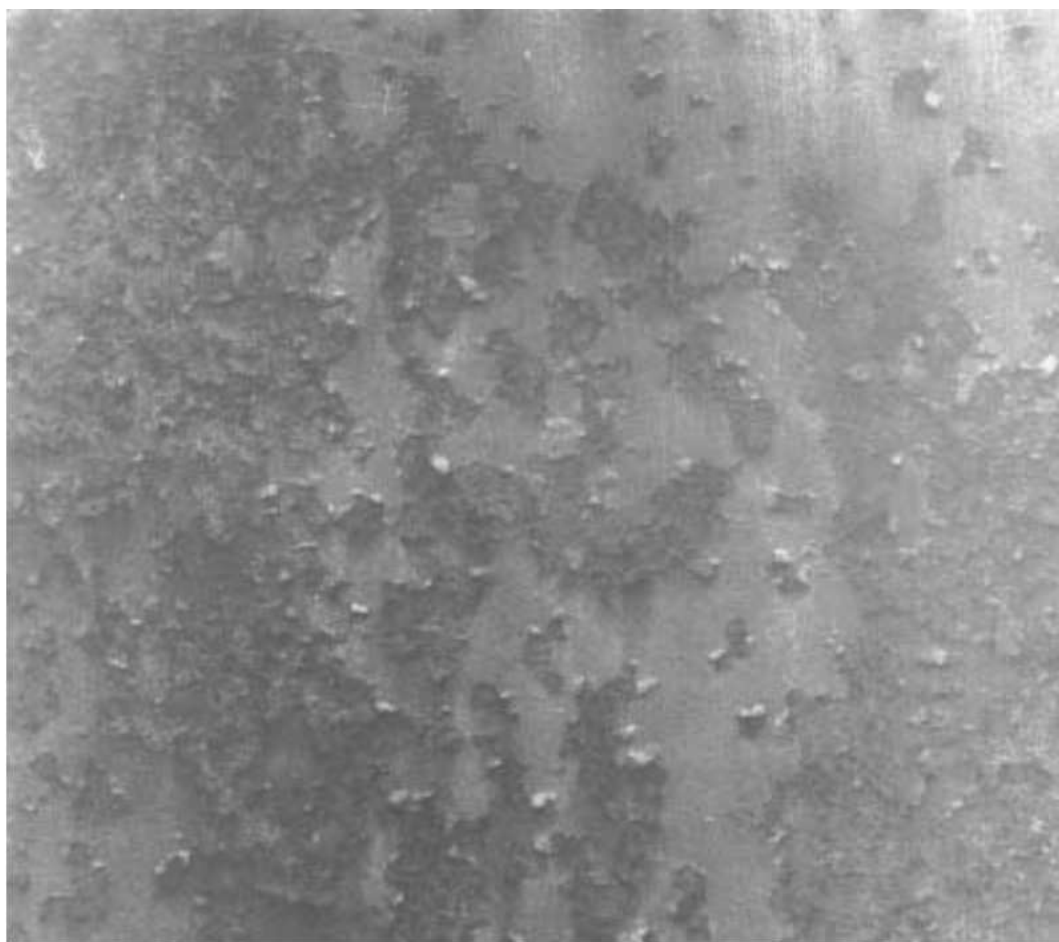
Рисунок 13 – Коррозия металла балл Ri5
