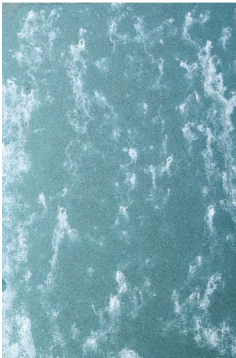
Рисунок 17 – Коррозия металла балл WRi4
