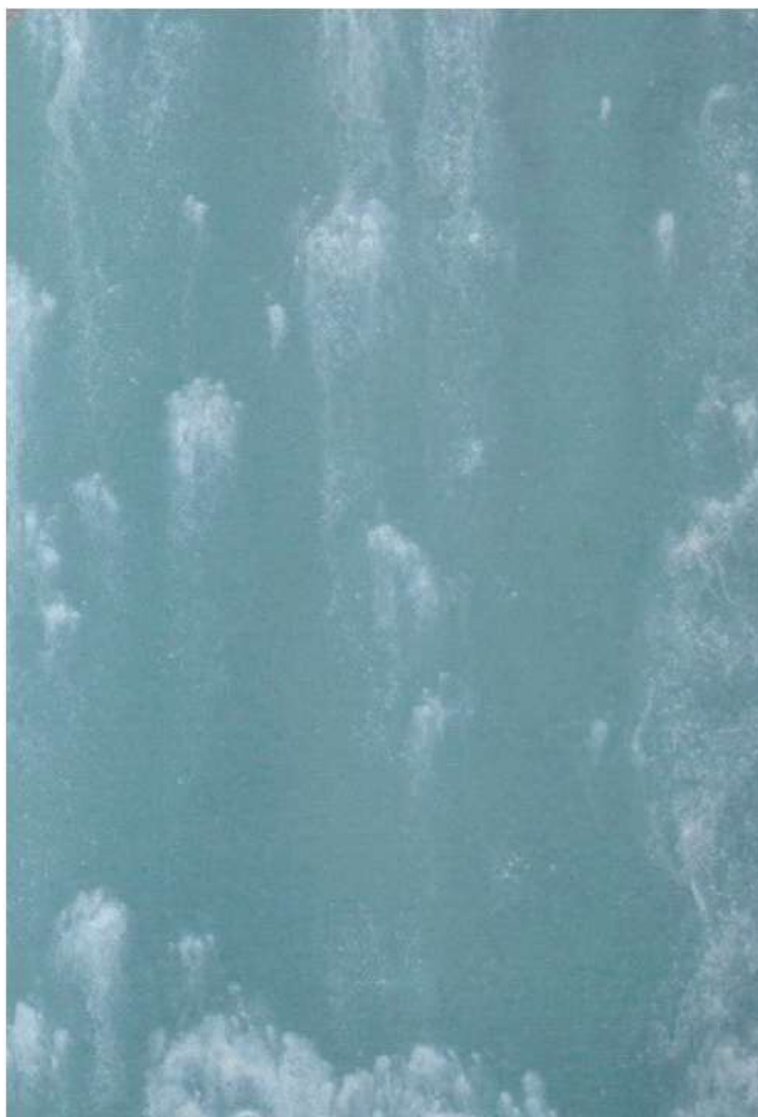
Рисунок 15 – Коррозия металла балл WRi2
