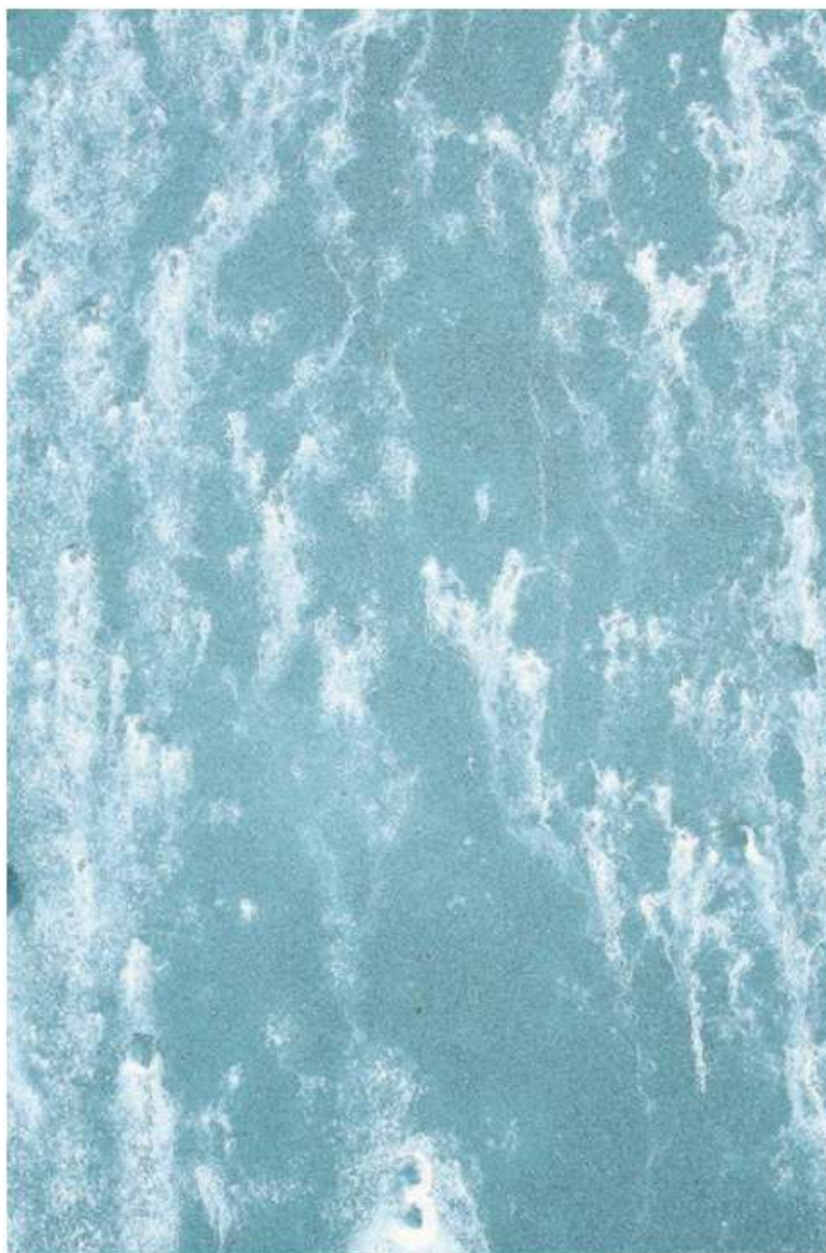
Рисунок 18 – Коррозия металла балл WRi5
