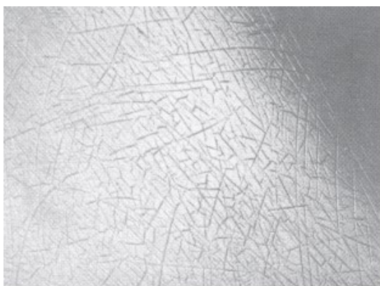
Рисунок 6 — Образование сетки поверхностных трещин лакокрасочного покрытия
